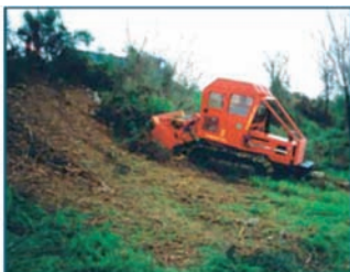
MIDIFORST montat pe un senilat la crearea unei benzi de protectie pentru incendii
