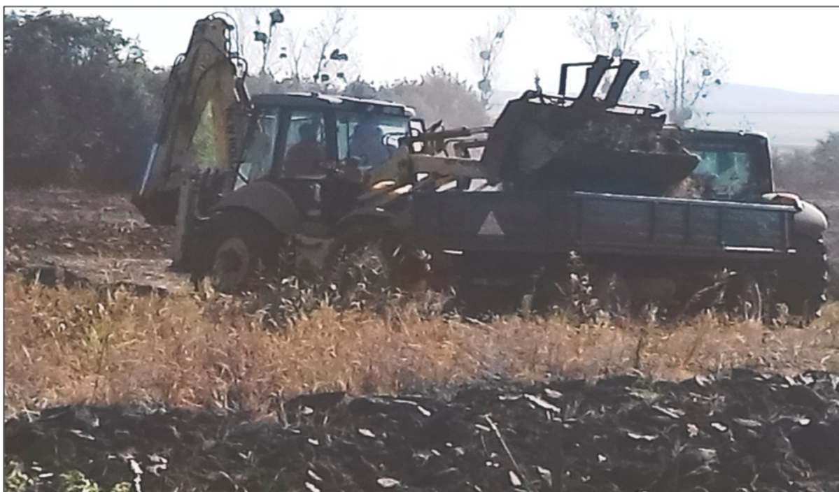
Fig. 5: Executarea lucrărilor de îndepărtare a vegetației și scoaterea cioatelor. Foto: M. Budeanu (2017)
